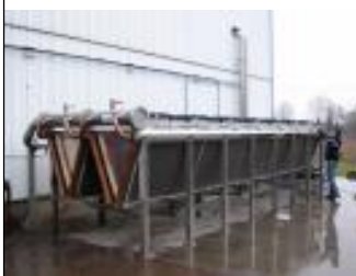
Die perfekte Freikühlung Trockenkühlsystem EDK System: Ecodry-Tec
